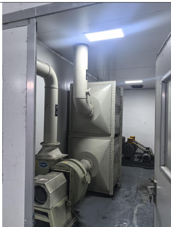
污水站废气处理
