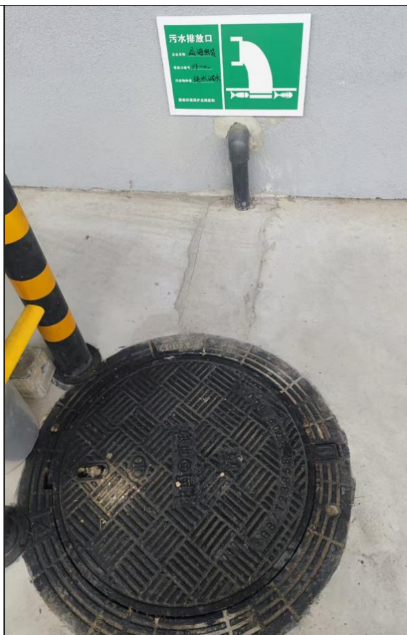
厂区污水处理站
