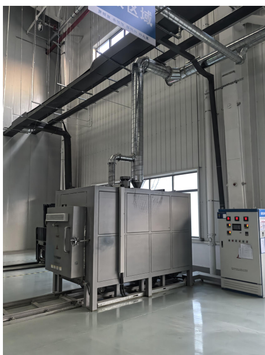
废气收集管道
